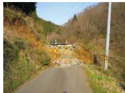
地震により段差ができた林道
