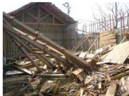
地震で壊れた農業用倉庫
